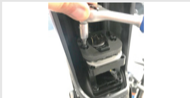
Obr. 35: Povolení šroubů držáku akumulátoru
